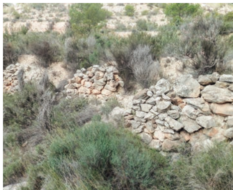
Figura 4. Restos de un murete afectado por ciclos de humectación y desecación en el Palomaret, Petrer
