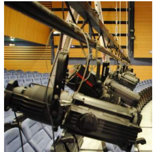
Vara Motorizada y electrificada
